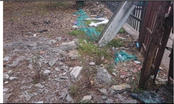
Estado del acceso principal al Salón Comunal Los Monjes
